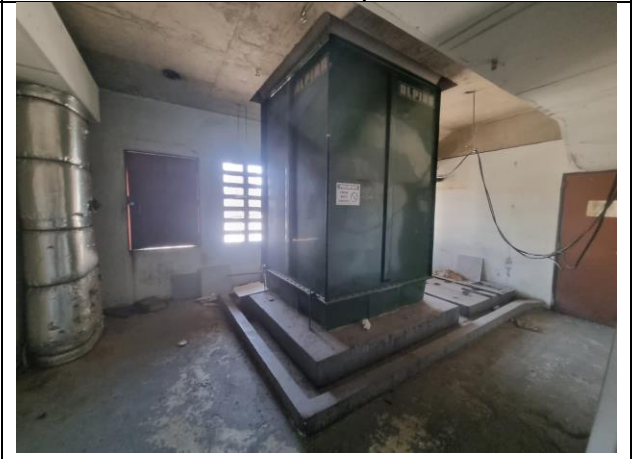
Foto 27: Sala de máquinas
