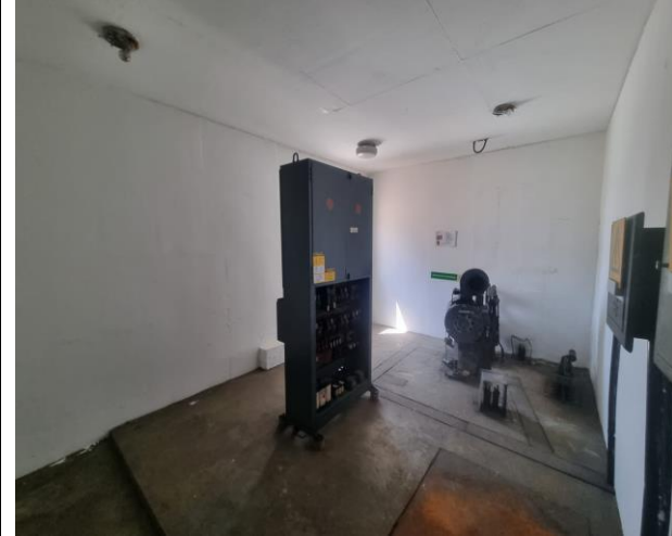
Foto 27: Sala de máquinas
