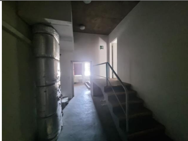
Foto 27: Sala de máquinas
