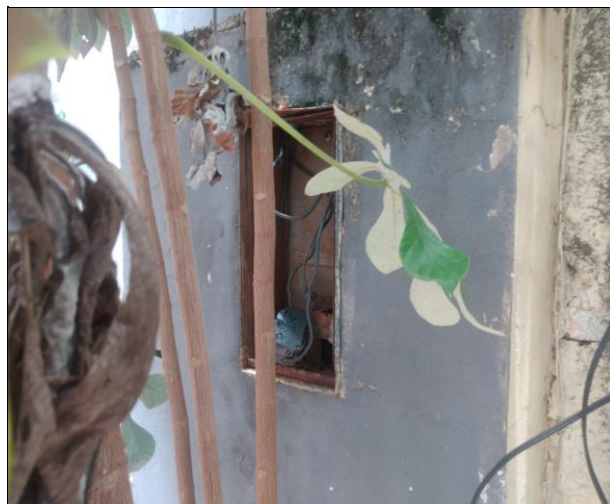
14 - Medidor de energia
