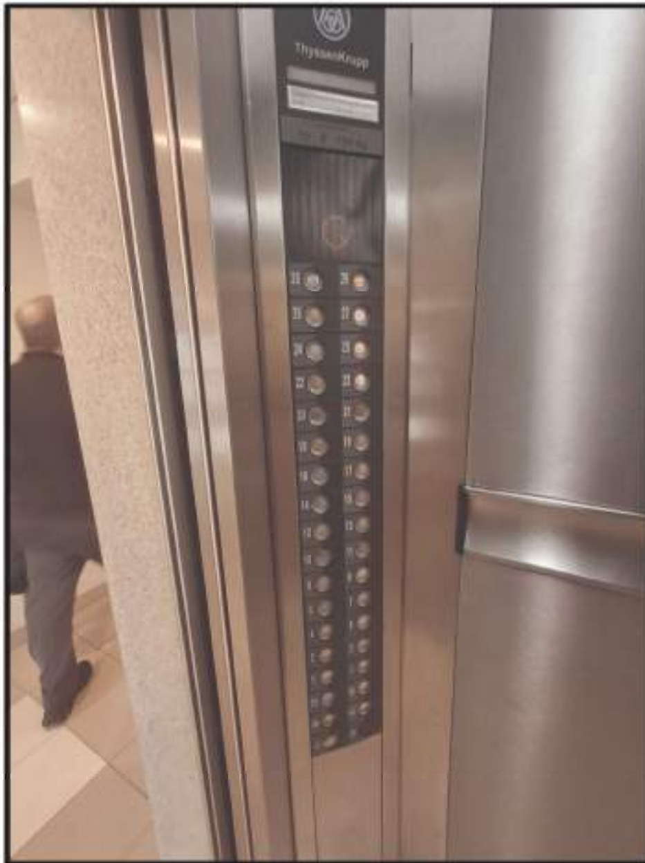
Foto nº 12 – Ilustra a botoeira de comando do elevador.
